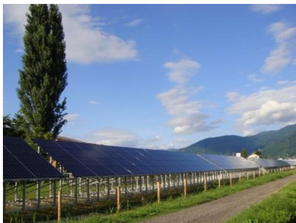
太陽光発電所施工実績
